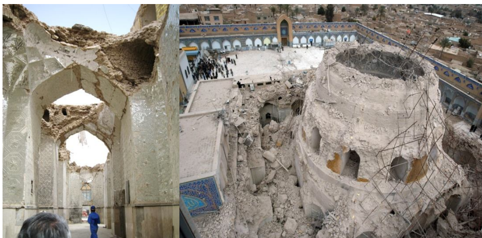
شکل ۳: بخشی از وضعیت دیوارها و سقف سازه ساختمان پس از تخریب. شکل ۴: تخریب نسبتاً کامل سقف سازه.
